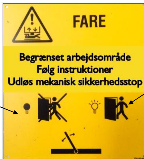
Advarselsskilt i skaktgrube
